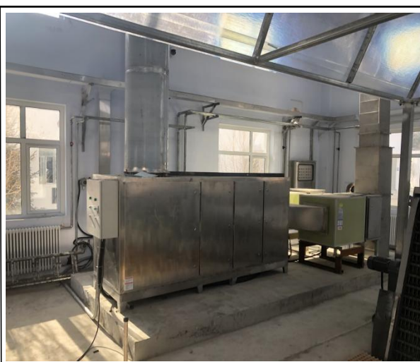
图 3-2 离子除臭设施+15 米排气筒
